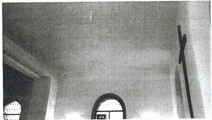
Im Deckenbereich sind und deutliche Verfärbungen der Wände zu erkennen. Der Kerzenruß hat seine Spuren insbesondere im vorderen Bereich der Kapelle hinterlassen.
